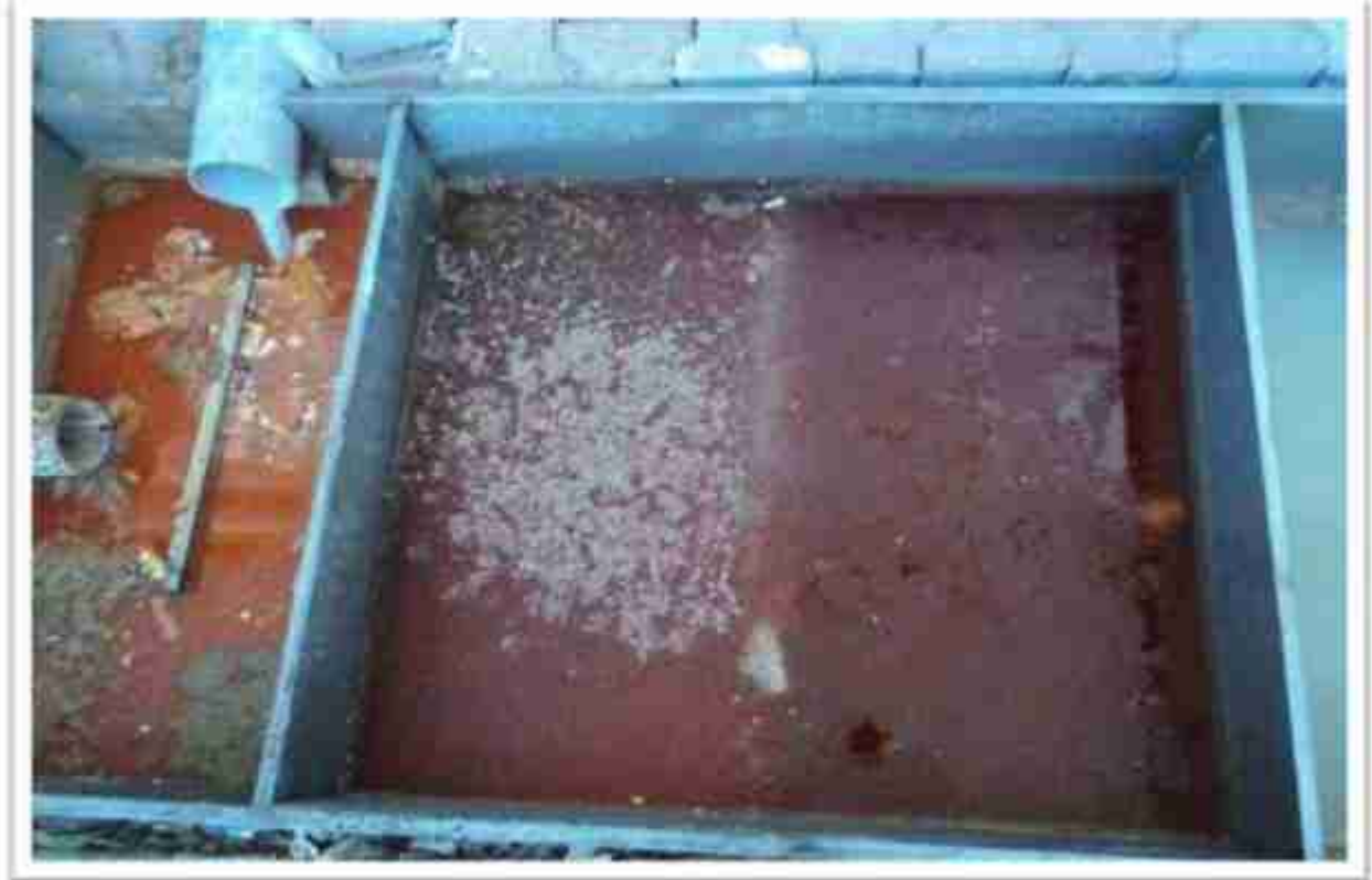
Resim 23: Yağ tutucu giriş ve orta kısmı
