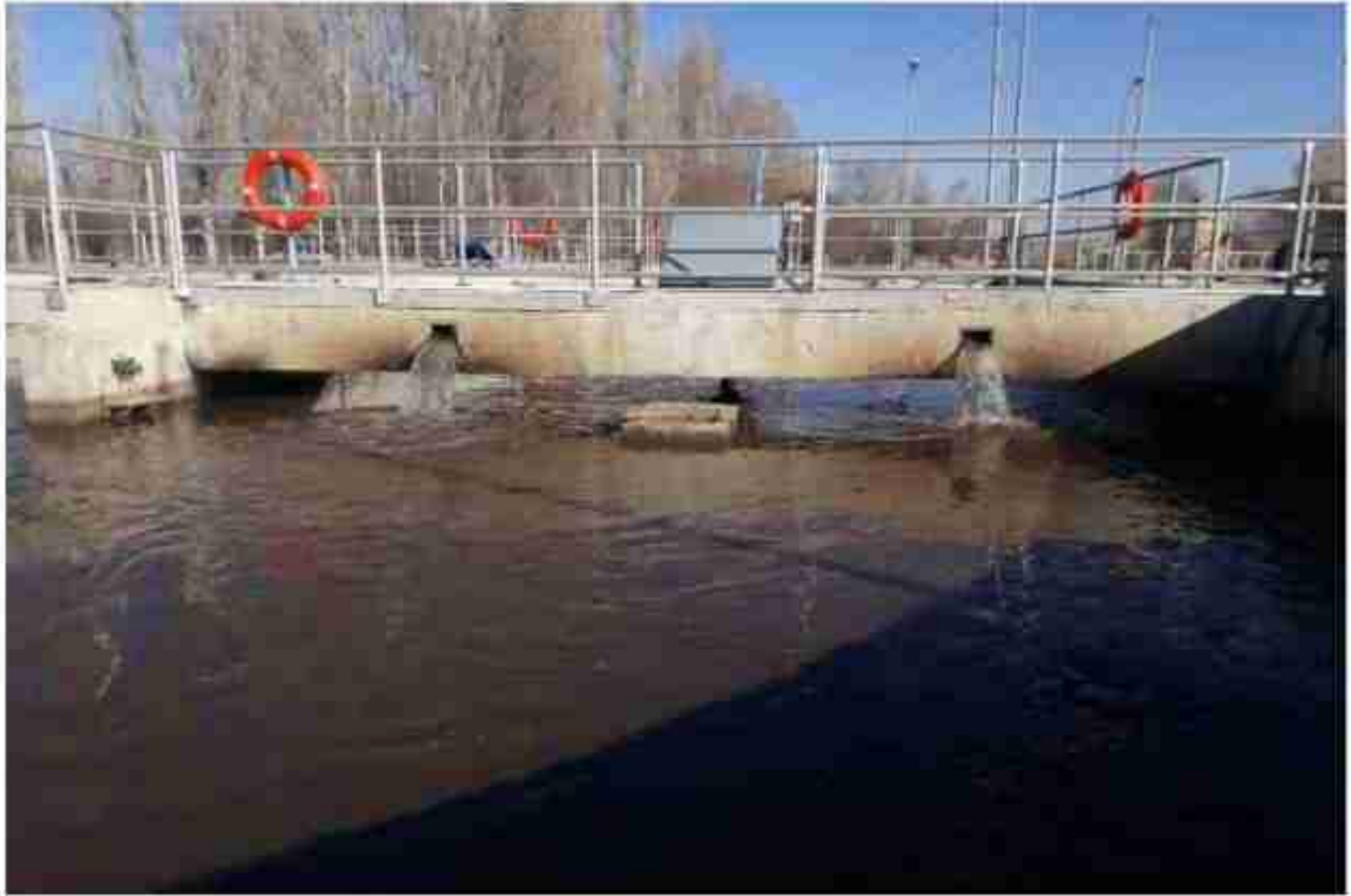
Resim 27: Düzağaç Atıksu Arıtma Tesisi Havalandırma Havuzları
