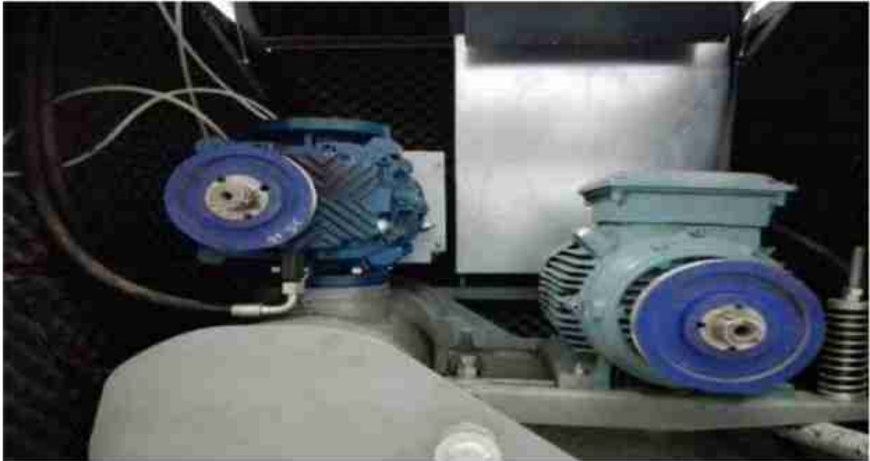
Resim 81: Roots Blowerların Elektrik Motoru Rulman Değişimi
