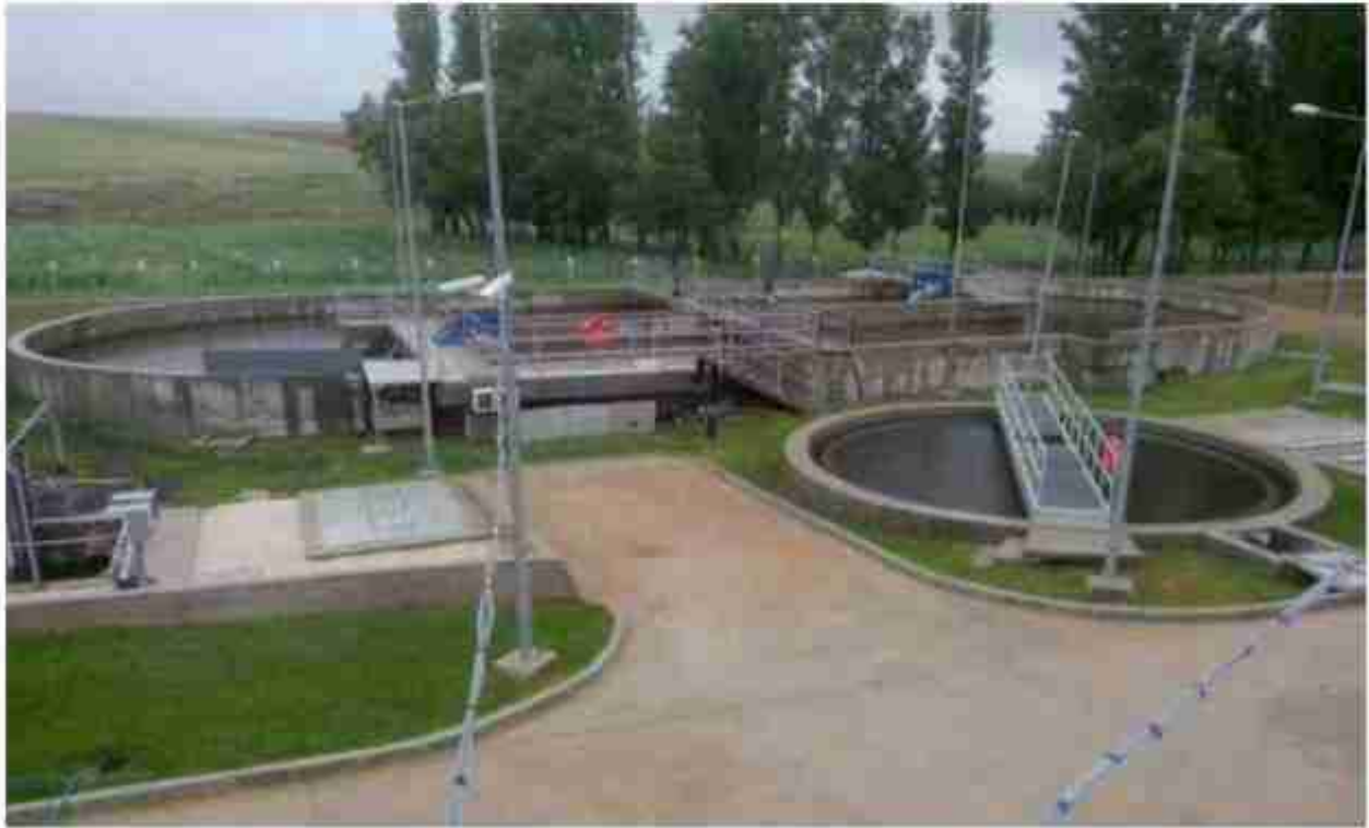
Resim 26: Düzağaç Atıksu Arıtma Tesisi Havalandırma ve Son Çöktürme Havuzları
