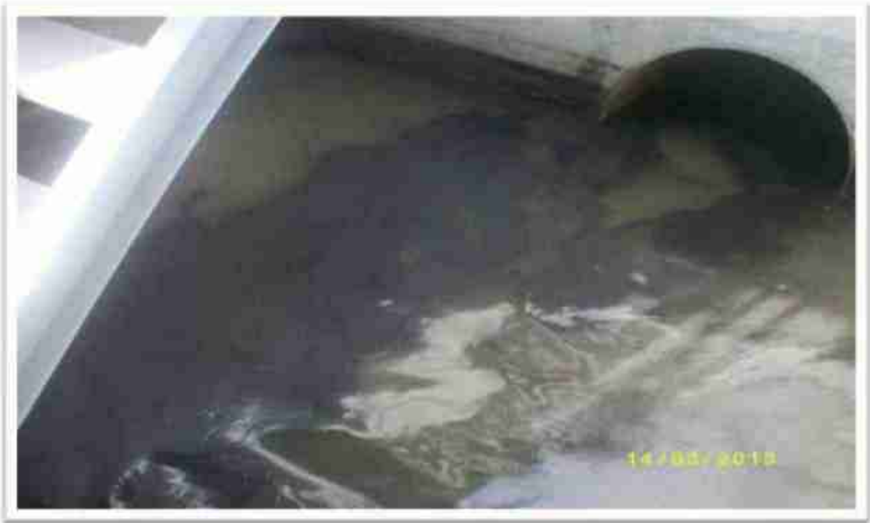
Resim 19: Kanalizasyon Şebekesine Bırakılan Yabancı Maddeler: Yağ -Gres
