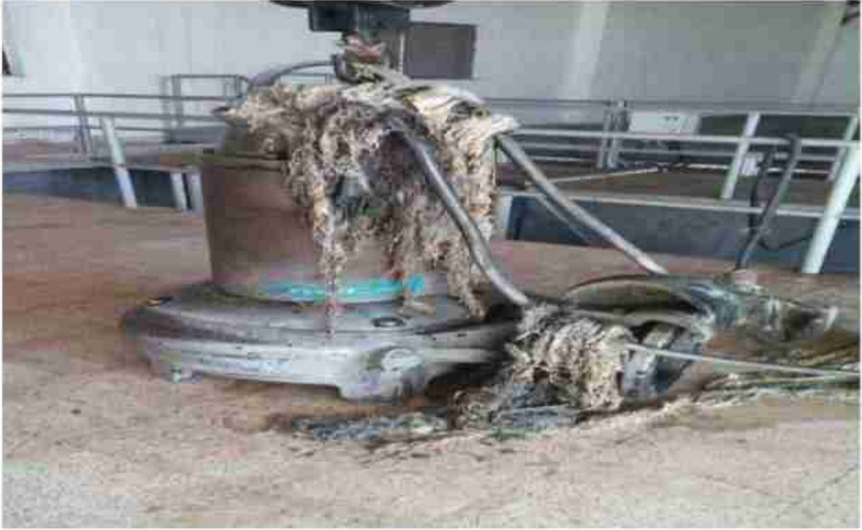
Resim 68: Terfi Pompalarına dolanan ıplıksı malzemeler
